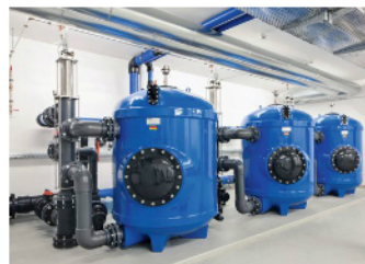
Diese Behncke-Anlage wurde im Europa Park Rust, im Erlebnishotel „Bell Rock“ installiert. Zusammen mit dem DAISY-Wasseraufbereitungssystem erreicht man hervorragende Wasserwerte.
